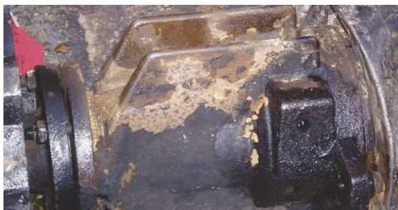
Bild 19.36 Leckage an Pumpe [Quelle: NESS]
