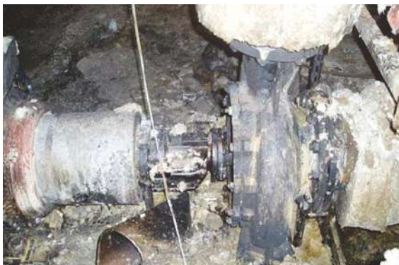
Bild 19.39 Pumpe nach Brandschaden [Quelle: NESS]
