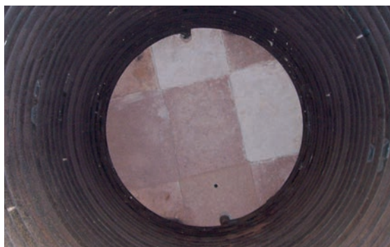
Paroi arrière de l'appareil de chauffage en béton réfractaire léger
